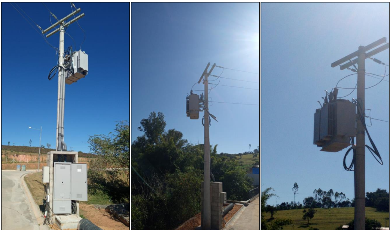
Foto 01: Transformador e disjuntor instalado.
